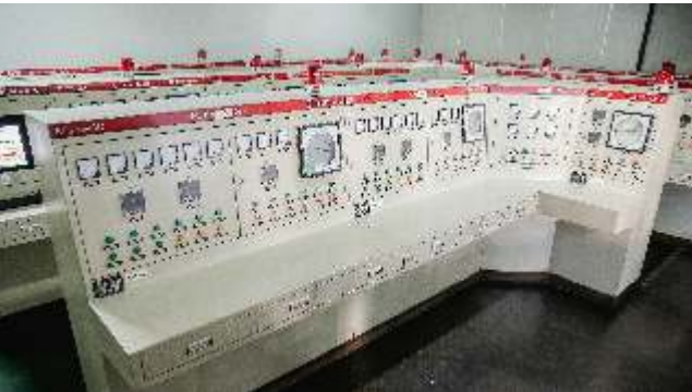
热处理控制室
