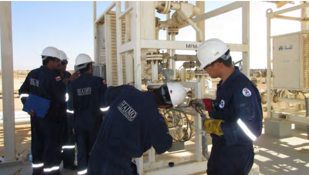
多相流量计现场安装调试
