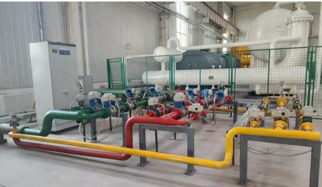
油气水三相环线实验室
