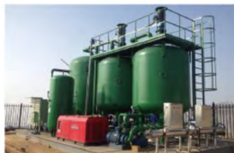
长庆油田某注水站
