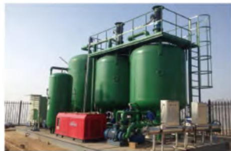
长庆油田某注水站
